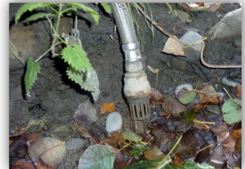
Tuyau équipé d'une crépine non vulnérable
